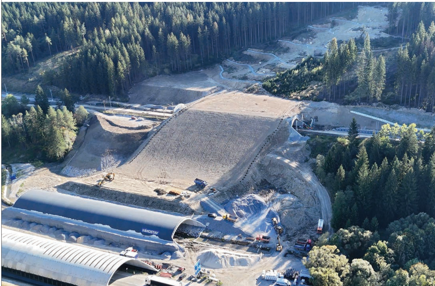
Obr. 5 Stav na stavbe začiatkom septembra 2024, vpravo hore zrealizovaná časť sanácie zosuvu Fig. 5 Construction site in early September 2024, with the completed landslide stabilisation visible in the upper right
