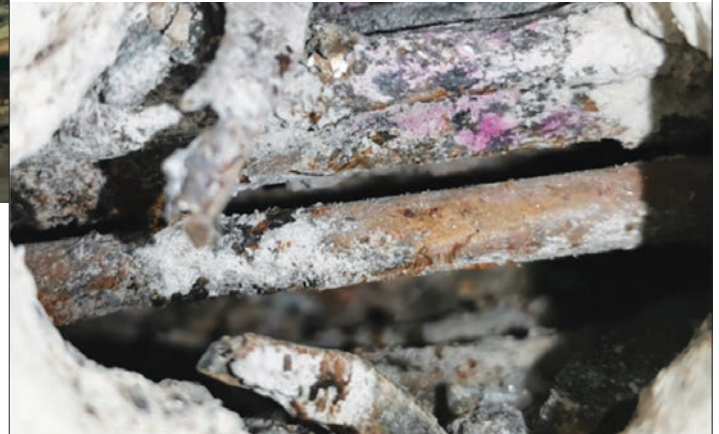
Obr. 7 Nezainjektovaný kábel s korodujúcimi a pretrhnutými predpínacími drôťmi v zdvíhanej časti
