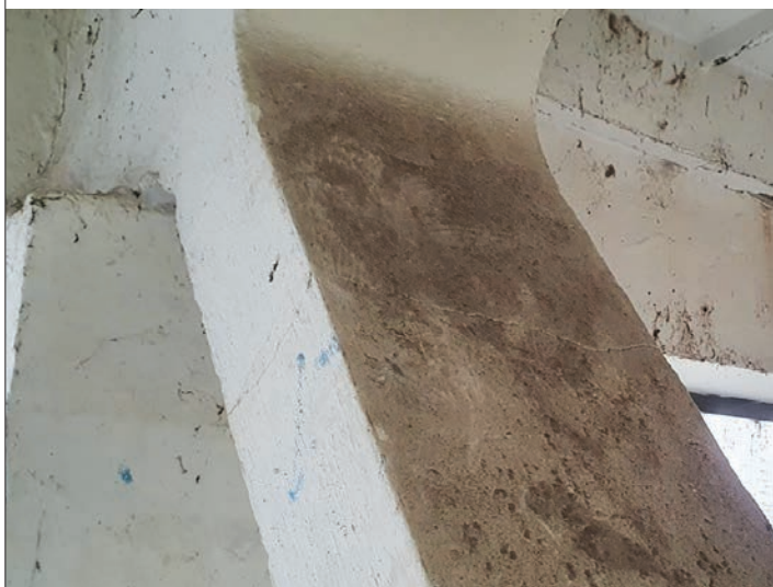
Obr. 3 Ťahová trhlina v krajnej diagonále väzníka Fig. 3 Tensile crack in the outer diagonal of the truss
