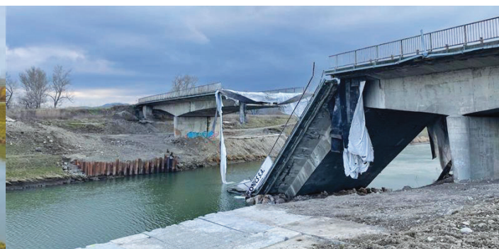
Obr. 2 Demolícia stredného poľa po odstrele Fig. 2 Demolition of the central span after blasting
