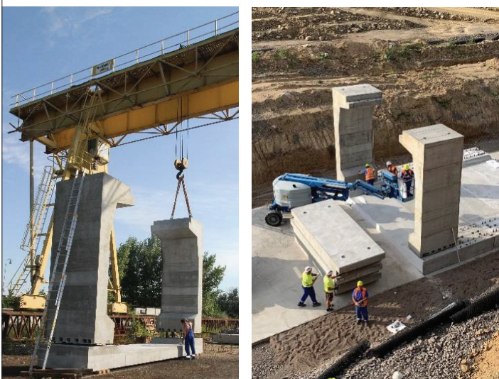
Obr. 3 Skúšobná montáž – vľavo, reálny postup výstavby vpravo Fig. 3 Test assembly – left; actual construction process – right
