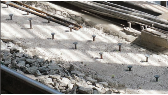
Obr. 5 PSB® trne použité pri nadbetonávke mosta, Helsinky, 2022 Fig. 5 PSB® Headed bars use in bridge overlay, Helsinki 2022
