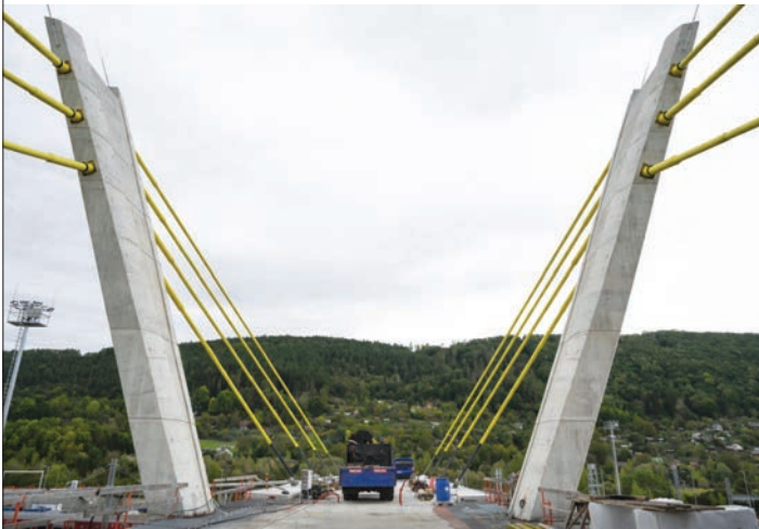
Obr. 5 Pohľad na sklonené pylóny mosta (zdroj: Jarmila Uhlíková) Fig. 5 A view of the bridge's sloping pylons (source: Jarmila Uhlíková)
