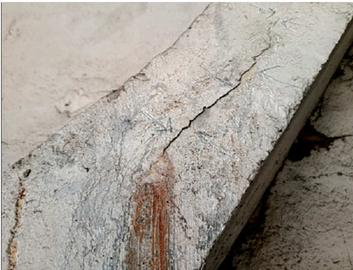
Obr. 4 Pozdĺžna trhlina na krajnej predpätnej diagonále so stopami korózneho výtoku
