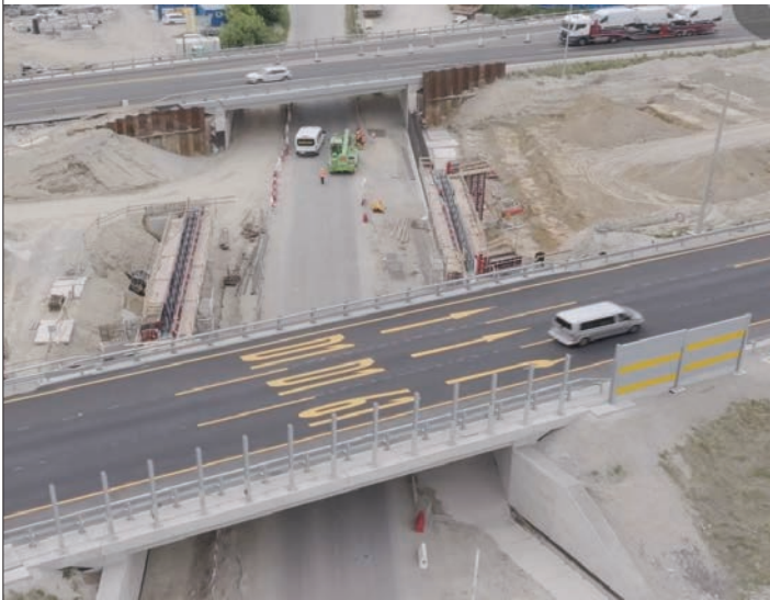
Obr. 3 Most na kolektorových pásoch ponad ulicu Pri mlyne, výstavba mosta na D1
