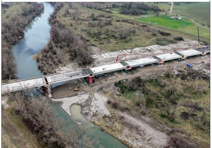
Obr. 6 Nová mostná koňštrukcia nad Váhom Fig. 6 New bridge superstructure over the Váh River
