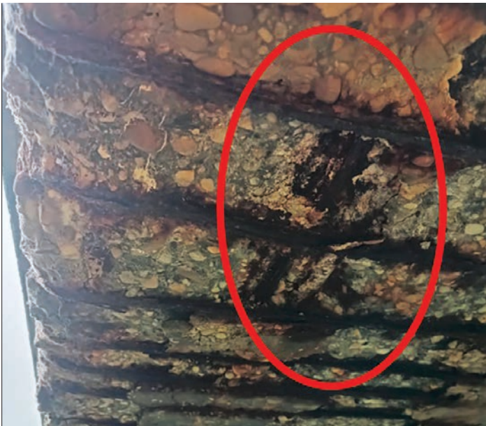
Obr. 5 Nízke krytie strmeňov, rozsiahla delaminácia krycej vrstvy zapríčinená expanziou korozívnych splodín s následným obnažením káblových kanálikov
