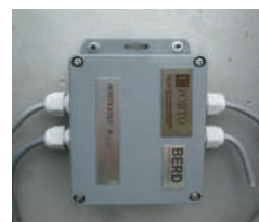
Detalhes de instrumentação: caixas de acelerómetros. Details of the instrumentation: accelerometer boxes.
