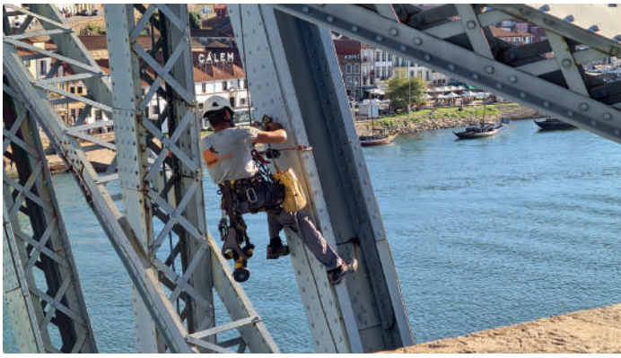
Instalação de sensores em fibra ótica na Ponte Luiz I. Fiber optic sensor installation on the Luís I Bridge.
