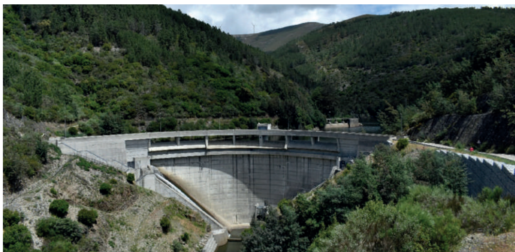
Barragem do Alto Ceira, com a nova barragem em primeiro plano e a barragem desativada em segundo plano (a barragem do Alto Ceira I foi desativada e parcialmente demolida em 2014 devido a fendilhação significativa, com passagem de água pelas fendas, resultante do desenvolvimento deletério da RAS; foi substituída por uma nova barragem, barragem do Alto Ceira II, construída a jusante da barragem desativada). The Alto Ceira II dam is shown in the foreground, with the decommissioned Alto Ceira I dam visible in the background. The Alto Ceira I dam was decommissioned and partially demolished in 2014 due to significant cracking and leakage caused by alkali-silica reaction (ASR). It was replaced by the new Alto Ceira II dam, which was constructed downstream of the original dam's site.
