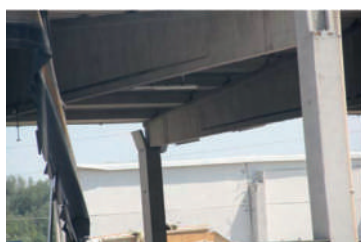
Danos observados em edifícios industriais pré-fabricados sob ações sísmicas. Damages observed in Precast industrial buildings under seismic actions
