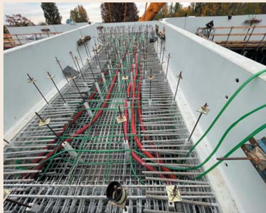
Fig. 14 View of the Superstructure – cooling and spacer blocks Obr. 14 Pohled na nosnou konstrukci – chlazení a distanční bloky
