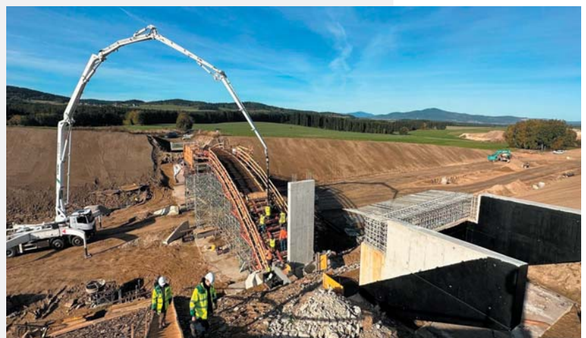
Fig. 7 Bridge No. 209 during construction of the arch Obr. 7 Most č. 209 během betonáže oblouku
