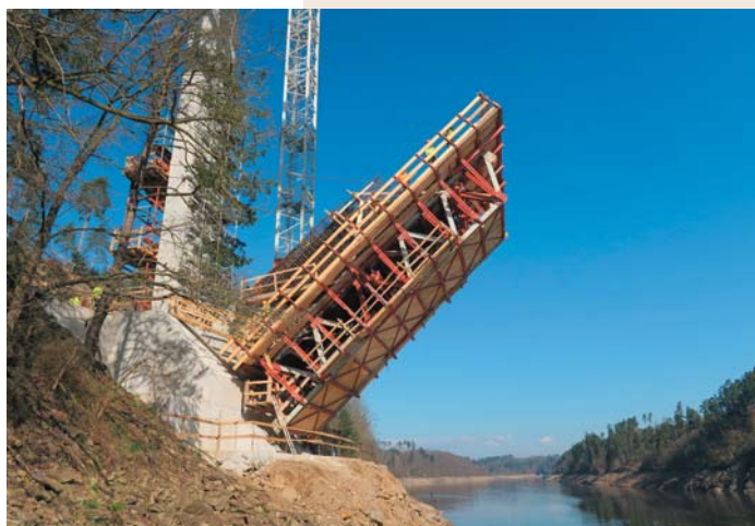
Fig. 6 Formwork for the first part of the arch Obr. 6 Bednění první části oblouku
