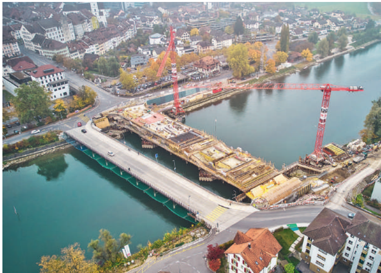
Fig. 6 Luftaufnahme, Blick in Richtung Süden, links die Hilfsbrücke in Betrieb und rechts die neue Brücke im Bau. Aerial view, looking south, the auxiliary bridge in operation on the left and the new bridge under construction on the right. (© WMM Ingenieure AG, Marc Gilgen)
