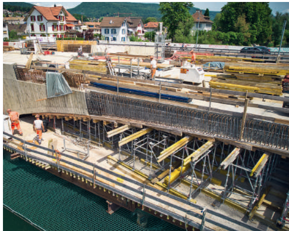
Fig. 8 Bau des Mittelfelds, oberwasserseitig. Construction of the centre field, upstream. (© WMM Ingenieure AG, Marc Gilgen)
