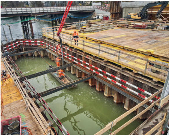
Fig. 7 Spundwandkasten südlicher Pfeiler. Sheet pile box, southern pier. (© WMM Ingenieure AG, Marc Gilgen)
