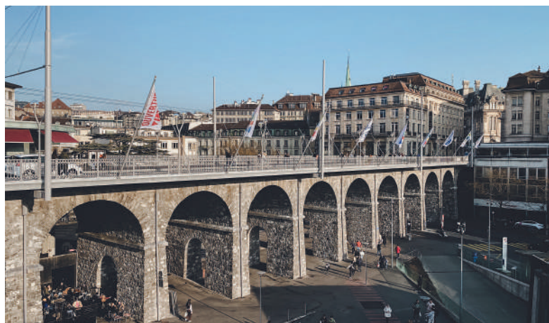
Fig. 6 Vue du pont après les travaux de remise en état. View of the bridge after renovation work.
