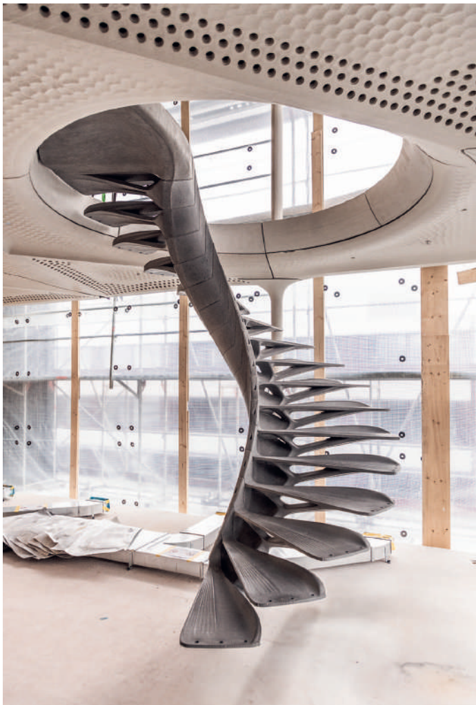
Fig. 16 Treppe Cadenza vor der Montage der Absturz-sicherung. Stairs before installation of railing. (© A. Jipa, Digital Building Technologies, ETH Zürich)
