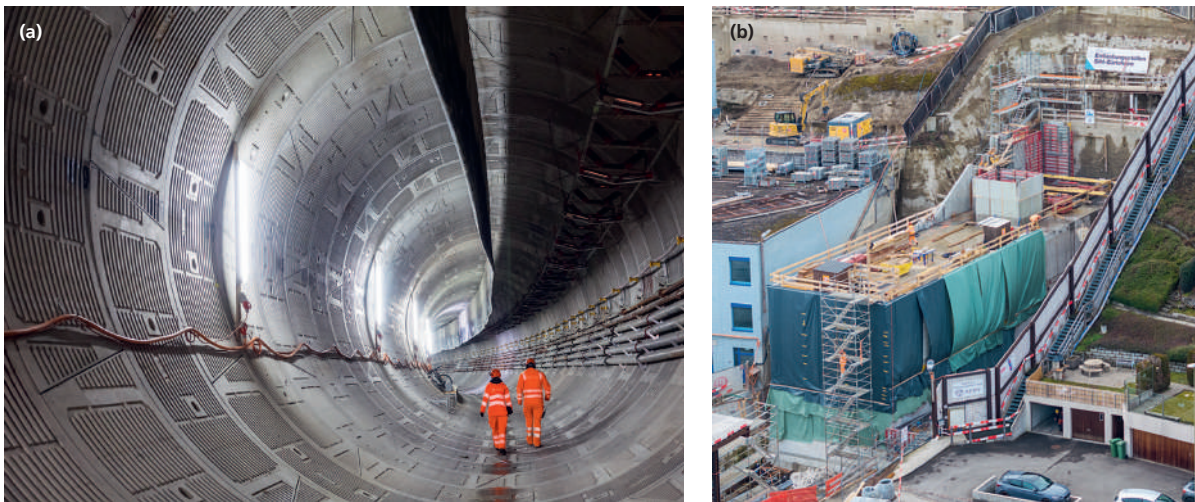
Fig. 5 a) Entlastungsstollen mit gerippten Tübbinges (Aug. 2024) und b) Betonierarbeiten am Tosbauwerk (Jan. 2026). a) Diversion gallery with ribbed lining segments (Aug. 2024) and b) concreting of the dissipation chamber (Jan. 2026). (© AWEL)
