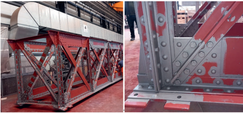
Fig. 10 Erneuerung des Korrosionsschutzes des Stahlfachwerkträgers. Renewal of the corrosion protection of the steel truss girder.
