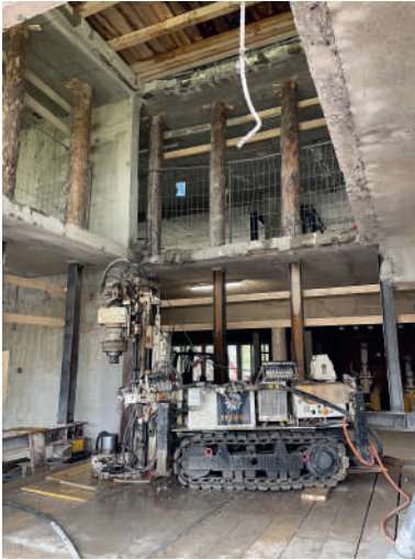
Fig. 6 Mikropfahlbohrgerät Treppenhaus Ost, Bohrplanum auf Plattform im EG. Micropile drilling rig in the east stairwell, with the drilling platform at ground floor level.
