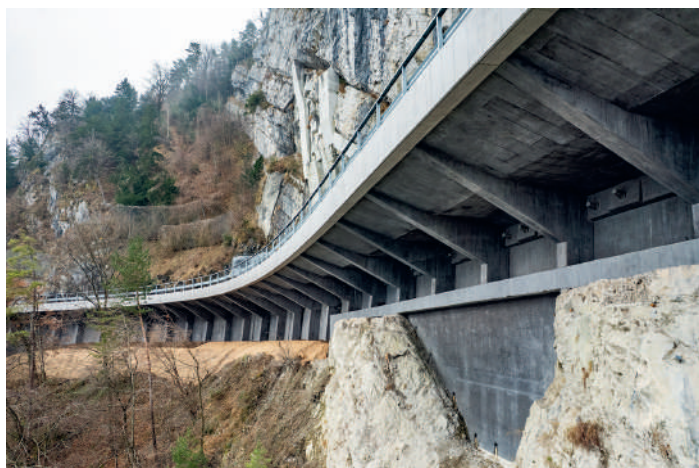
Fig. 7 Untersicht der Lehnkonstruktion aus dunkel pigmentiertem Beton und Konsolkopf aus normalem Beton. Im Vordergrund die Betonplombe. Bottom view of the slope-supported viaduct made of dark-pigmented concrete with the parapet in standard concrete. In the foreground: the concrete sealing layer.
