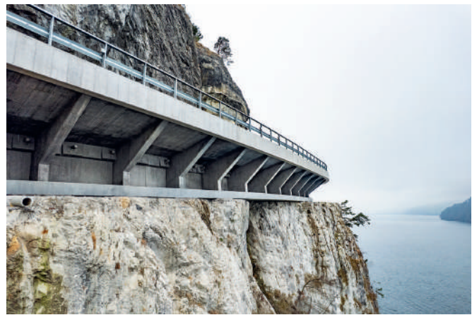
Fig. 4 Die Lehnkonstruktion ist knapp auf dem Felsen aufgelegt. Im Hintergrund die Überbrückung, wo sich das «Streifenfundament» ganz vom Untergrund löst. The slope-supported viaduct is narrowly supported on the rock. In the background, the bridging section where the "strip foundation" completely separates from the subsoil.
