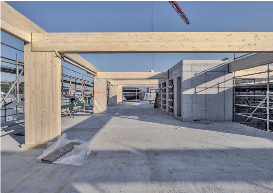
Fig. 6 Die Aufstockung erfolgte in Holzbauweise. The extension was constructed using timber. (© René Dürr, Zürich)
