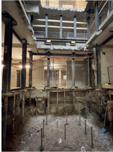
Fig. 7 Abgebrochenes Treppenhaus West mit Notspriessung auf Mikropfählen. Demolished staircase west with temporary supports on micropiles.
